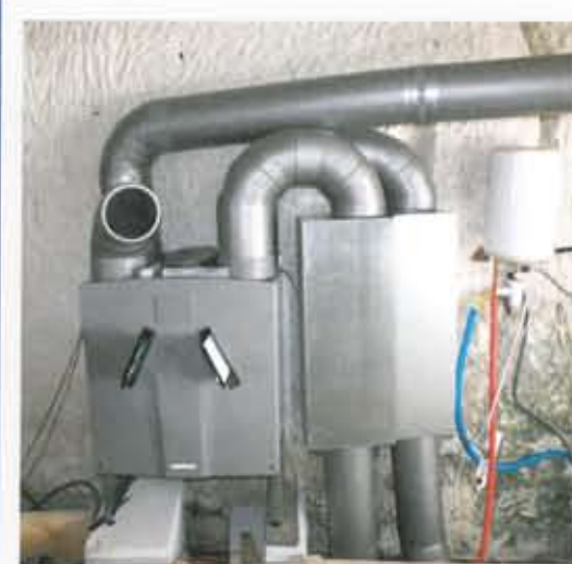
► L'air extérieur passe dans l'échangeur afin d'être réchauffé avec l'air sortant. L'air réchauffé passe alors dans un silencieux pour atténuer les bruits et est acheminé vers le distributeur qui l'envoie dans chaque pièce via un réseau de gaines. L'air vicié suit un chemin inverse.
