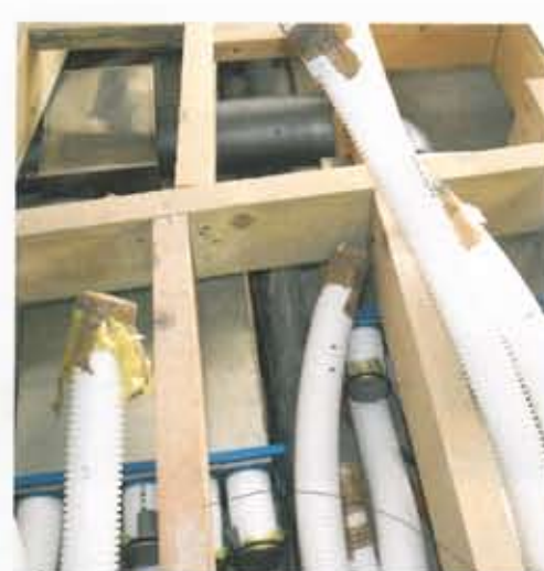
► L'ensemble des éléments techniques – collecteur, distributeur, batterie thermique – ainsi qu'une grande partie du réseau de gaines ont été installés sous un plancher technique en bois. Une solution adaptée à cette configuration et rendue possible en raison de la hauteur sous plafond.
